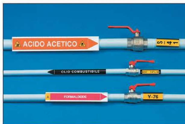
tubazioni con sistema TLS
